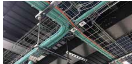
中国建设银行安徽分行 中心机房
